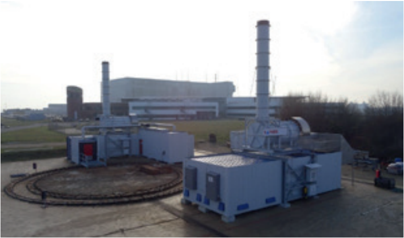
Nieuwe flash over- en nozzle-trainer met naverbrandingsinstallatie voor de SCBRNDCBV.
